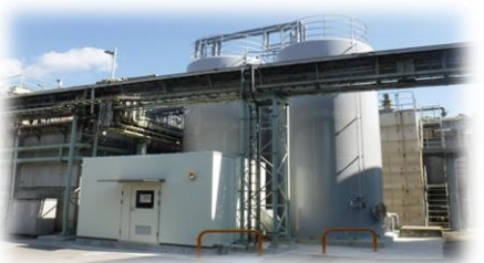
食品加工場排水処理施設 (平成27年10月納入・兵庫県)
