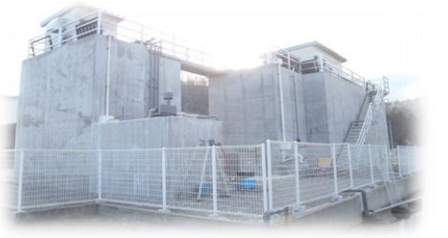
水産加工場排水処理施設 (平成27年9月納入・宮城県)
